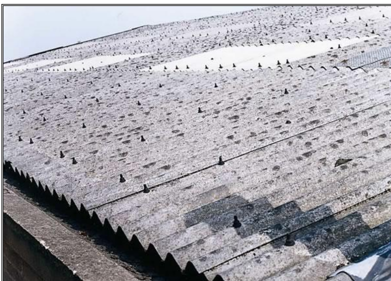
Rysunek 1. Dach pokryty azbestową płytą falistą
